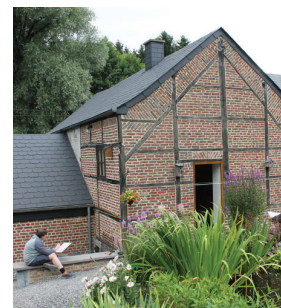
Maison sise à Miécrot, rue de l'Eglise n° 30. Pignon oriental de l'annexe en pans-de-bois © L. Hardenne.
