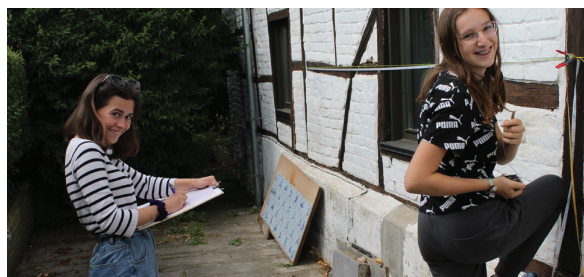
Maison sise à Miécrot, rue Cleuzer n° 9. Relevé du gouttereau sud-est © L. Hardenne.
